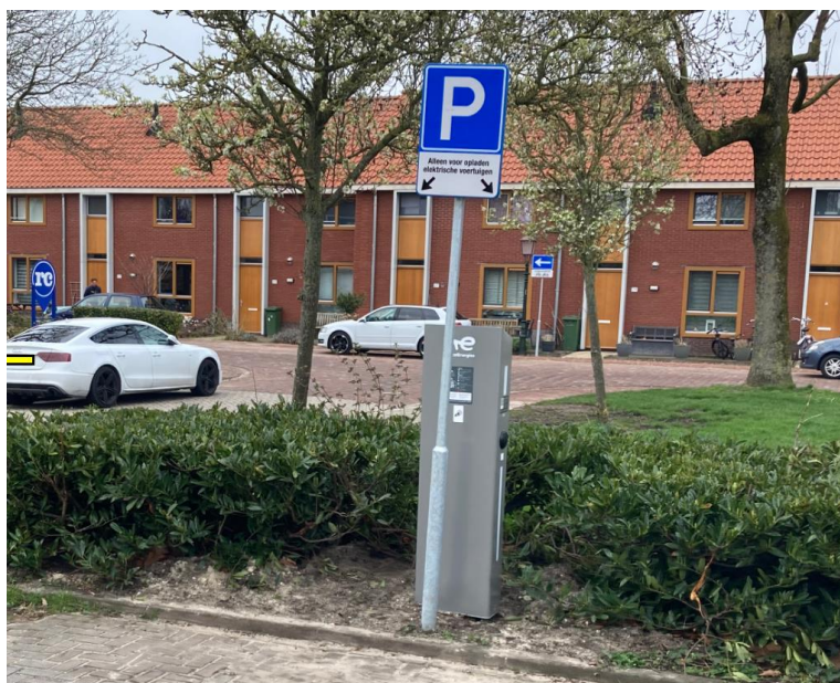
Figuur 12 Laadpaal bij openbaar groen in de Noorderstraat, Edam
